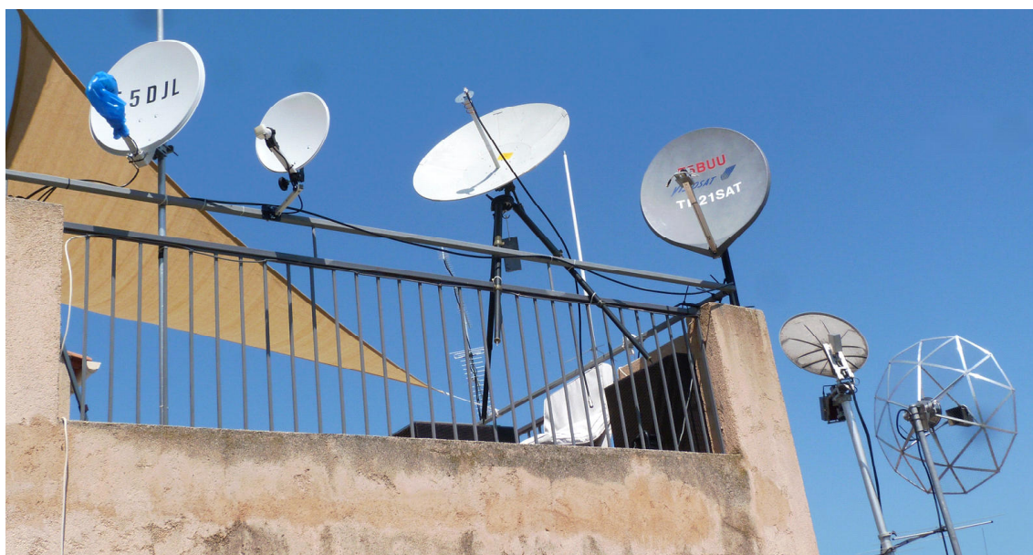
Une partie des antennes
